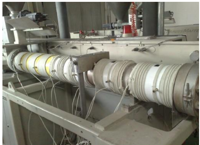
多台 5KW 在挤出机中的应用实例
